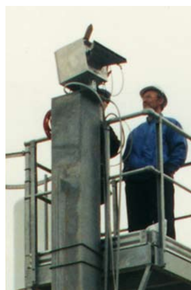
Scanner en ligne placé dans le boîtier de protection en haut de la tour d'observation
